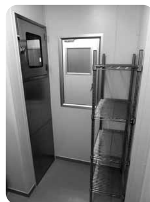
ハザード室側パスボックス
